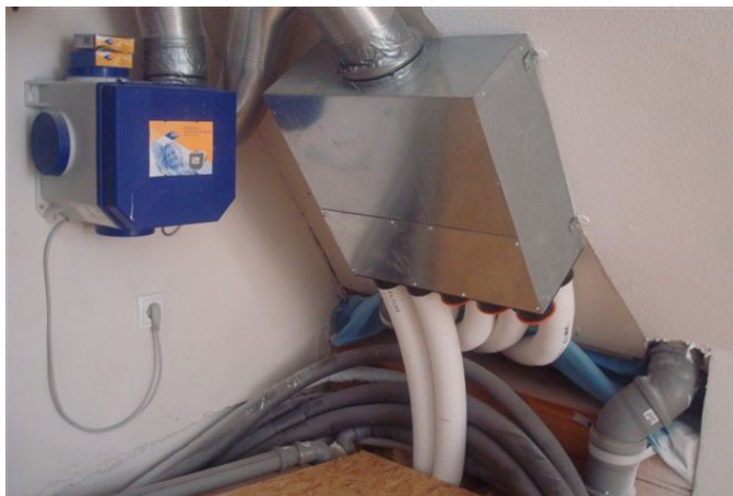
Foto 1: Mechanische ventilatie unit, uit metingen bleek dat de afvoer capaciteit in verschillende ruimten onvoldoende is. Er zal in dit geval een extra unit geplaatst moeten worden om te kunnen voldoen aan de ventilatie eisen.
